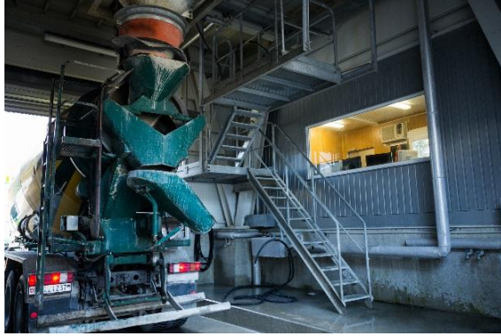
Centrale à béton
